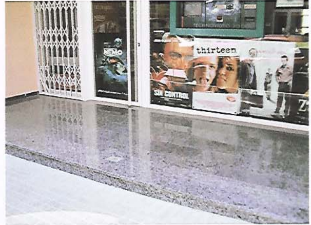
habiendo espacio mas que suficiente para haber podido construir una rampa de acceso
